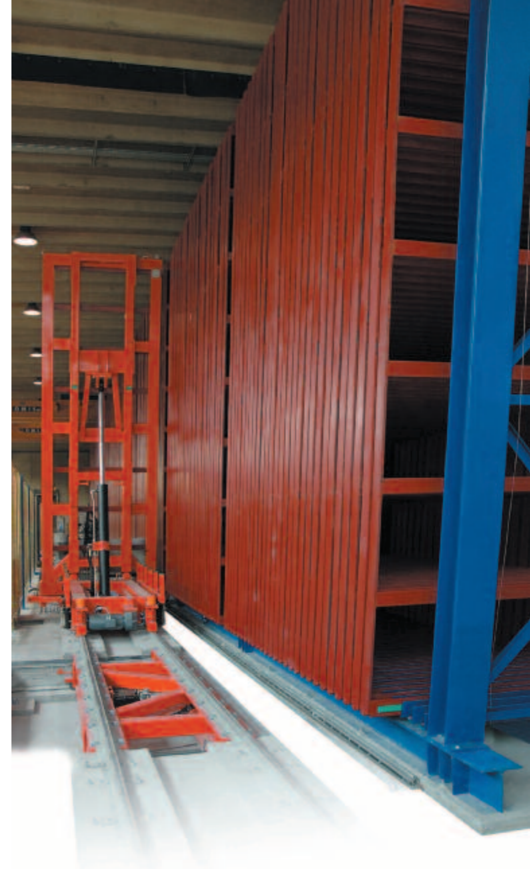
Stocks avec cadres mobiles intégrés à la structure fixe de l'installation
