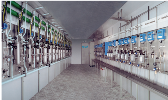
Apparecchiature di analisi all'interno di una sala di controllo di una centrale termoelettrica
