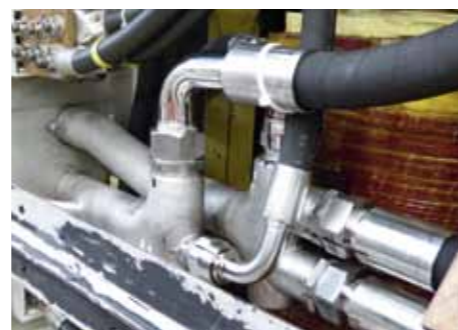
Raccordo di vari tubi flessibili di raffreddamento per convertitore di corrente
